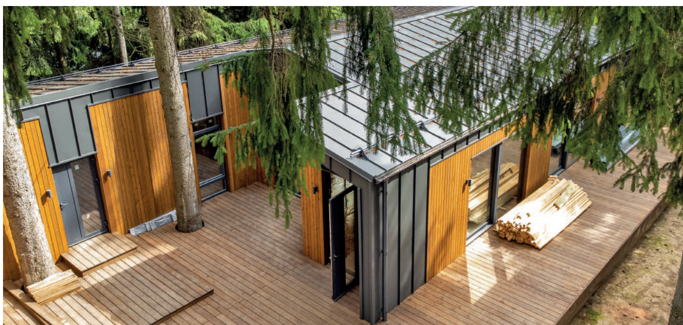
Кликфальц® Velur RAL7024, водосток металлический Grand Line 150/100 мм, снегзадержатели для фальцевой кровли Grand Line. Объект Varme
